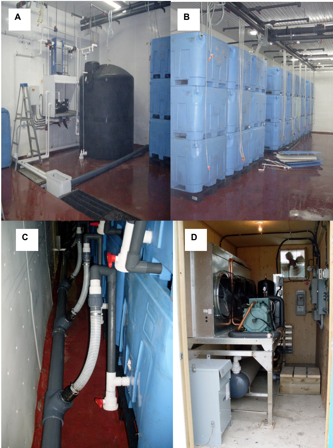
Figure 2: Photos montrant le système de refroidissement. A) Bassin, pompes, échangeur de chaleur et bacs de retour; B) vivier contenant 27 bacs isothermiques; C) système de récupération de l'eau refroidie à la sortie du vivier; D) refroidisseur d'eau de mer.
