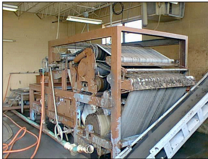
Figure 5.1 : Filtre-presse de la ville de Weirton en Virginie (USA) (Source: www.cityofweirton.com/wsb/treatment.htm )
